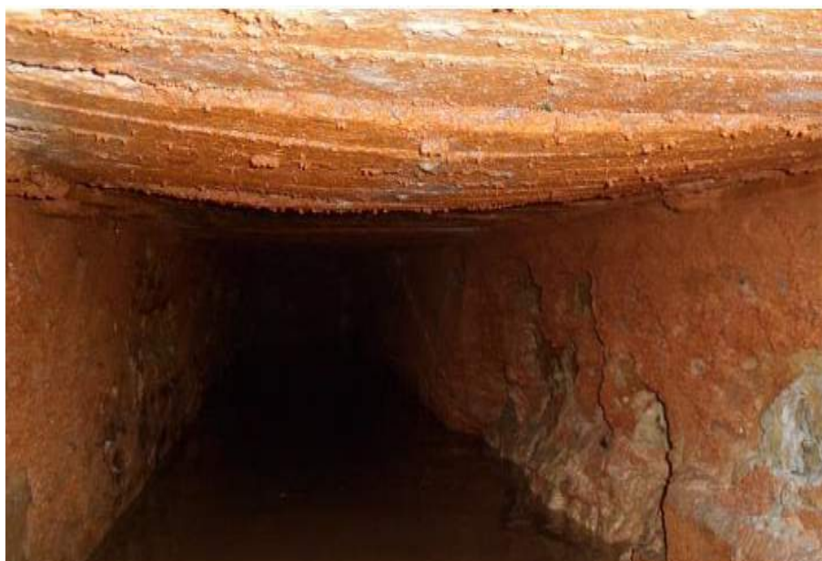
Figura 8: Interior do duto – paredes em tijolos e teto fazendo uma “barriga” sinal de possível ruptura. Fonte: dados da pesquisa.
