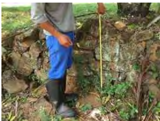
Figura 07: Medição de muro de pedra. Foto extraída do Relatório de Prospecção Trecho 2 (Fonte: ECOSSIS, 2015, p. 124).
