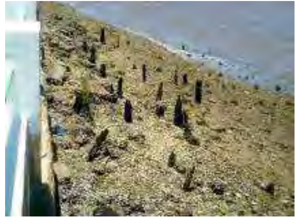
Figura 04: Estrutura 1 - vestígios dos pilotis da ponte do trapiche Lima, a partir do sul. Foto do autor, 2014.
