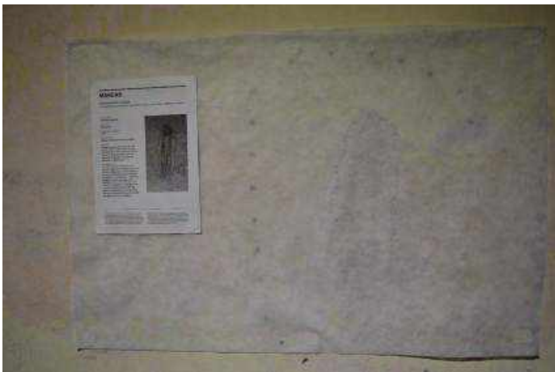
Figura 13: Marcas na parede.
