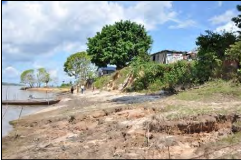
Figura 6: Barranco de acesso à comunidade erodido pelo rio Solimões.
