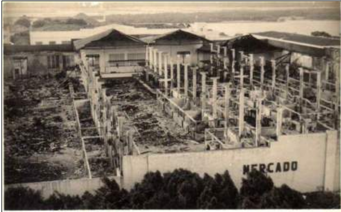
Figura 4: Mercado Público do bairro de Cidade Alta após incêndio 5 de 1967. Observar a disposição dos espaços no interior do mercado. Mesmo realizando vasta pesquisa não consegui localizar as plantas-baixas dos mercados aqui trabalhados. Mas, através desta perspectiva e da descrição presente no discurso, bem como com a experiência empírica, pode-se ter uma ideia de sua forma. Nesse sentido, com essa imagem, busquei evidenciar um pouco da realidade do interior do Mercado. Fonte: www.memoriaviva.com.br
