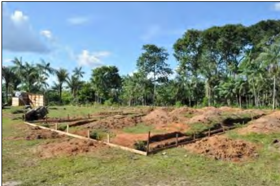
Figura 9: Área do sítio impactada pela construção de uma escola.
