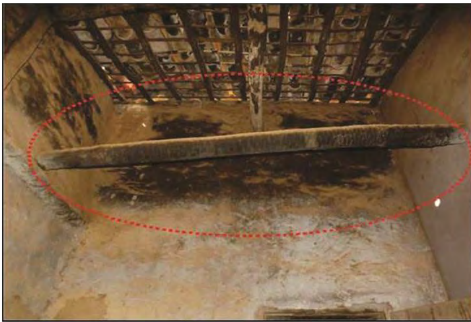
Figura 12: Emadeiramento de carnaúba e fuligem no alto da parede (Foto: RIBEIRO, Marcelo Alves, 2013)
