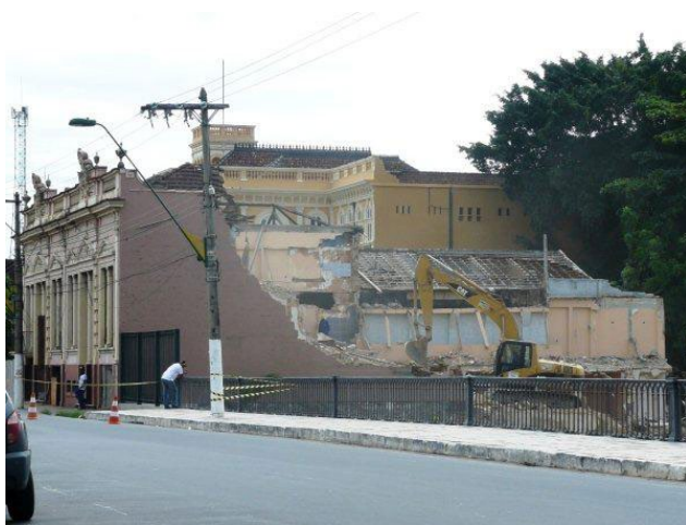
Figura 1. Demolição dos 4 Casarões geminados no ano de 2010. Fonte: Blog Palavra do Fingidor. Disponível em: http://palavradofingidor.blogspot.com/2010/01/crime-de-lesa-patrimonio.html
