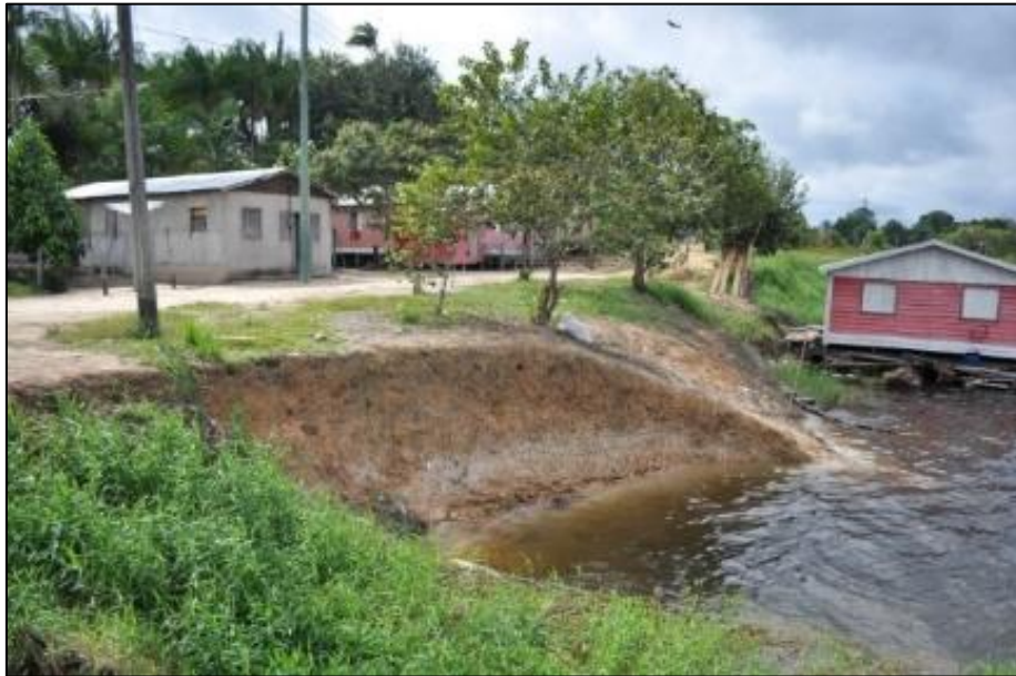
Figura 15: Barranco erodido pelo igarapé Açú na parte sul da comunidade.
