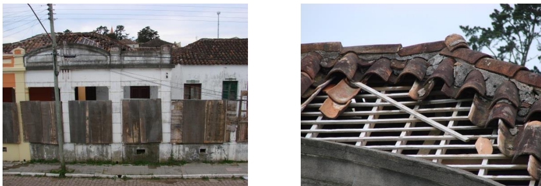
Figura 6: Na imagem à esquerda, 1: Parte do prédio que pertence à Prefeitura Municipal de Pinheiro Machado Fonte: acervo do NEAB, 2013. Na imagem à direita, 2: Lacunas na cobertura do prédio. Fonte: acervo do NEAB, 2013.
